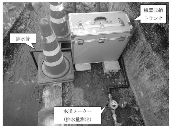
写真2 機器設置状況(B2)
