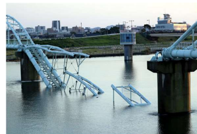
写真 3.1 落橋状況写真
