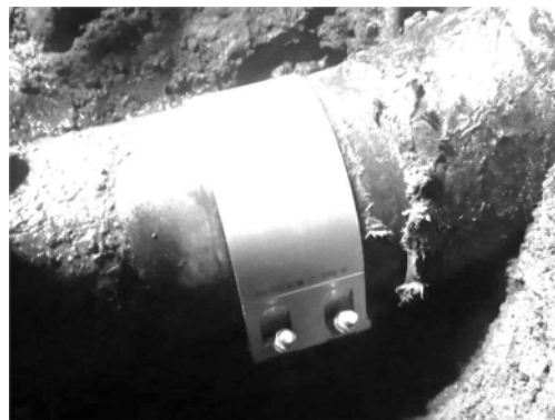
写真-2 事例2 (埋設管 SP300)
