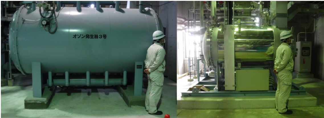
図-2 既設・新設オゾン発生器
