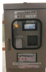
図 工業用水計器盤
