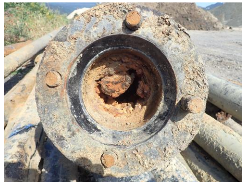
【閉塞が進んだ無ライニング DIP-A 内面】
