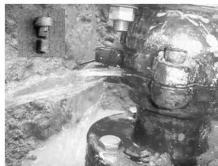
写真 1 本市における補修弁漏水
